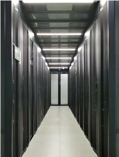
唯品会总部大厦数据中心
