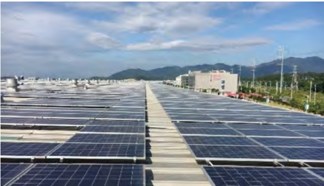
华中物流园区屋顶光伏
